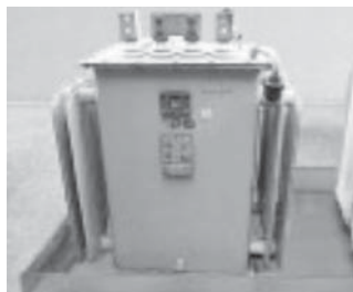
高圧トランス
